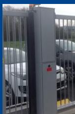
Motorisation dans caisson
